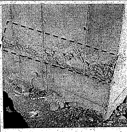
Fotografía N°2 - 22/3/2017: Nido de piedra ubicado en muro de hormigón armado en eje B1 con 01 del edificio destinado para la multicancha.
