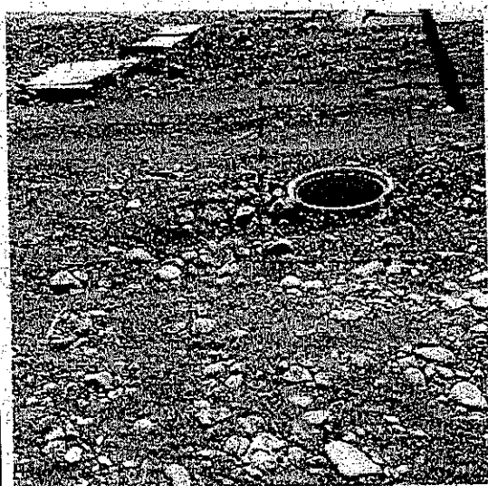
Fotografía N°43 - 23/3/2017: Cámara de alcantarillado ubicada en el sector de ingreso a la obra sin tapa ni algún elemento que advierta del riesgo de caída.
